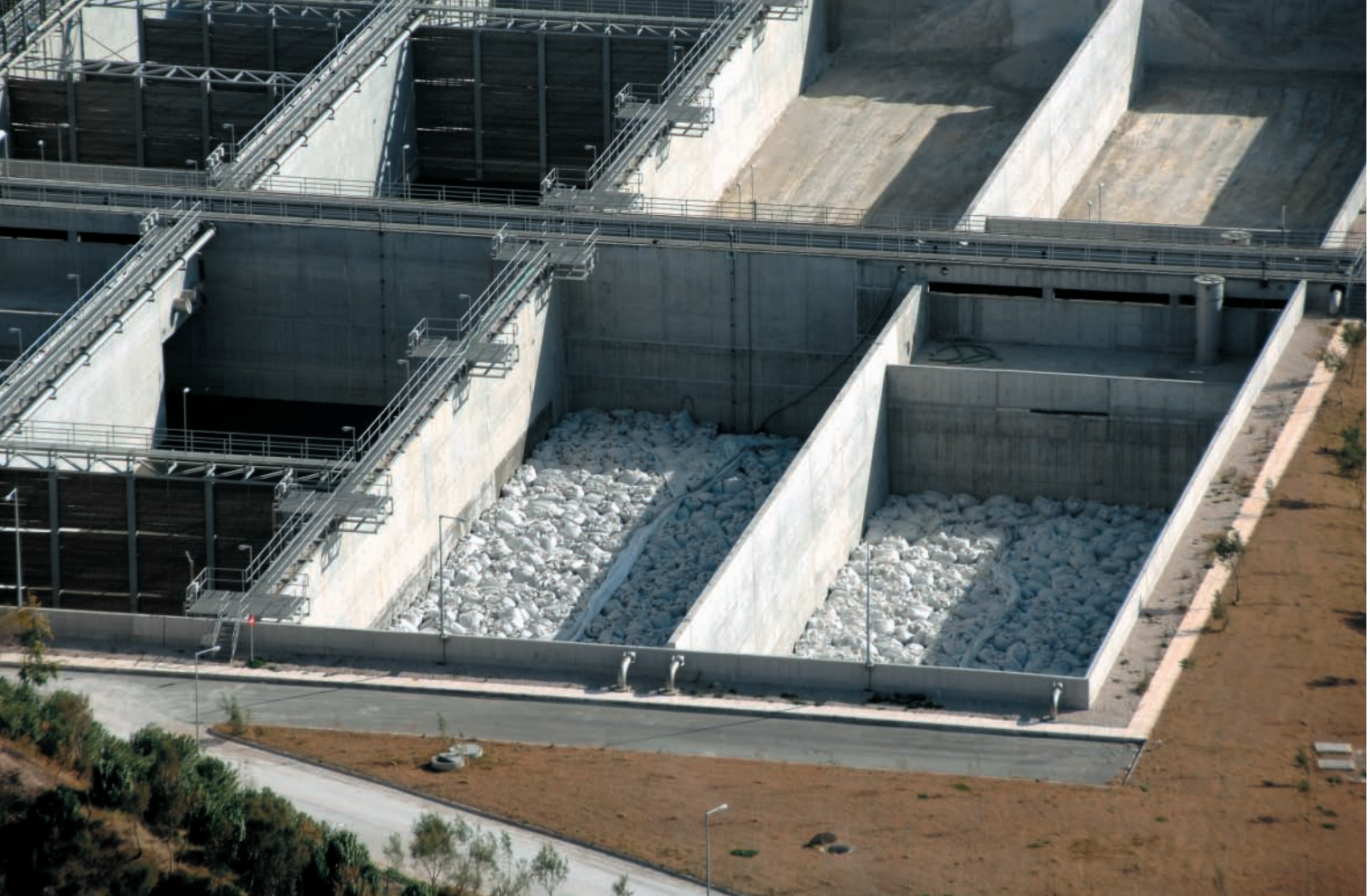
Τμήμα των εγκαταστάσεων του βιολογικού καθαρισμού της πρωτεύουσας. Τα έργα ξεκίνησαν με τυμπανοκρουσίες το 1984 χωρίς ακόμα να έχει εξασφαλιστεί η ξήρανση και η τελική διάθεση των παραγώγων.
